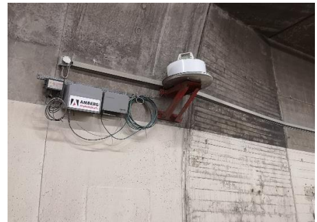
Mit Amberg GeoMonitoring System verbundener Tachymeter an der Tunnelwand in der Betriebsröhre
